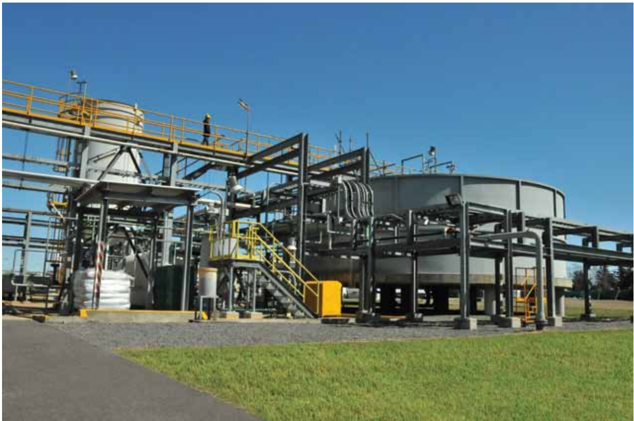
Planta de tratamiento de efluentes. Planta de Agroquímicos Zárate
